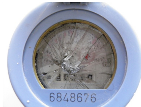
Das Glas ist beschädigt – deutlicher Hinweis auf einen Frostschaden des Wasserzählers
